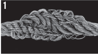
1 Die Stahleinlage nach Abschälen der Außenlitzen. Die akkumulierten Überlängen sind gut sichtbar.
