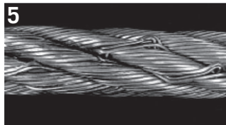
5 In diesem sechslitzigen Seil wurden die zwei äußersten Drahtlagen der Außenlitzen durch Seilverdrehung gelockert.
